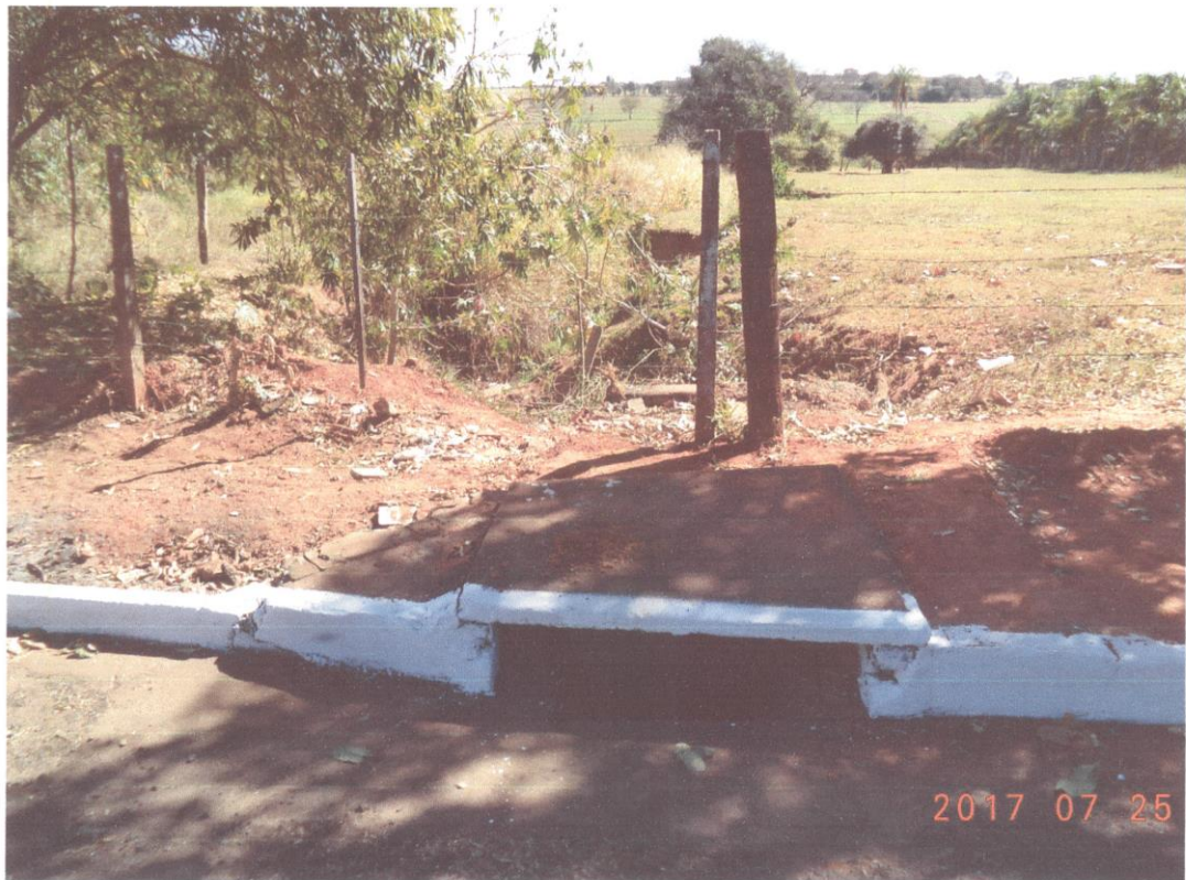
Foto 02 – Rua dos Pereiras esquina com Rua Rui Barbosa sentido Corrego Palmeiras.
